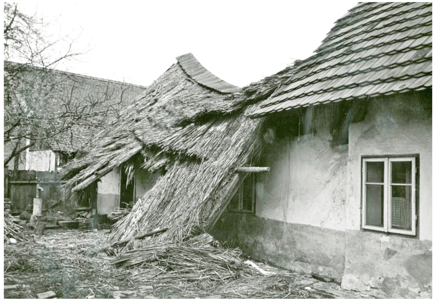
Obr. č.: 07. Pohled na zborcenou střechu hospodářské části v roce 1970, NPÚ ÚOP v Pardubicích, fotoarchiv, čp. 10 Rybitví
